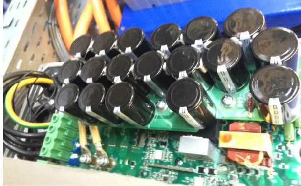
Abb. 28: Neu eingebautes internes Kondensatormodul
